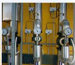
Instalação AVAC em Residências Geriátricas - Braga
